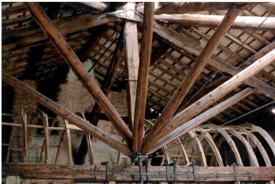
Particolare della struttura portante del Belvedere della Villa Reale di Monza, trattata con Salvalegno L30
